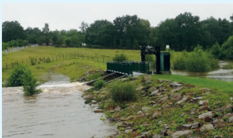
Ouvrage hydraulique à Châteaubriant
